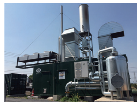
ガス発電機で発電した電気は電力会社を介して家庭などに供給される
